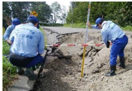
自治体所管施設の被災状況調査 (北海道勇払郡安平町)
