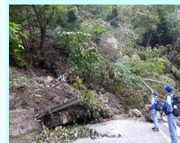
斜面崩壊箇所の調査(岩泉町)
