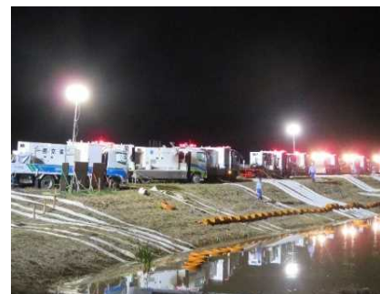
病院や住宅孤立の早期解消に向け 24時間体制で緊急排水を実施 (佐賀県大町町)
