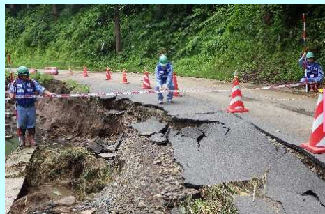
市道南外12号の被害状況調査(大仙市)
