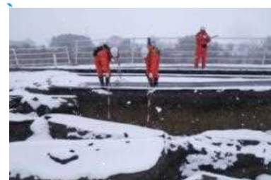
堤防被災状況の把握
