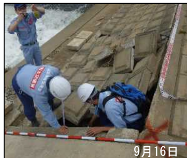
河川施設の被災状況調査
