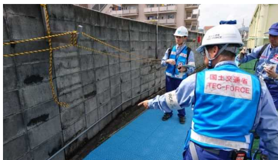
被災したブロック塀の応急危険度判定を実施 (大阪府 高槻市)
